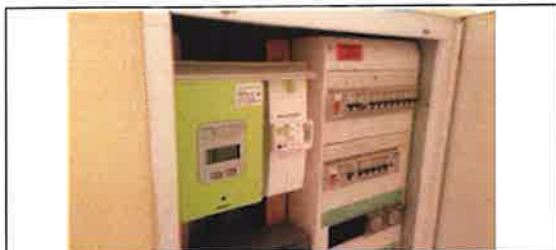
Photo du Compteur électrique
